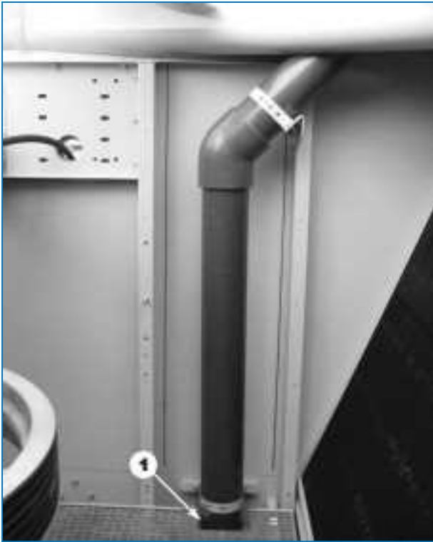
Tubature pompa sezione plenum interno
